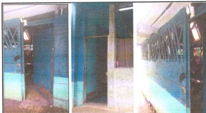
Foto 4: Sustitución de 2 puertas de madera por dos de metal y cambio de ventana de madera por ventada de metal con vidrio.
